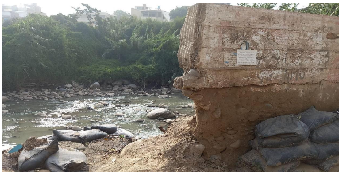
“Vista desde atrás del muro de contención deteriorado en la zona de pedregal Lurigancho-Chosica”
