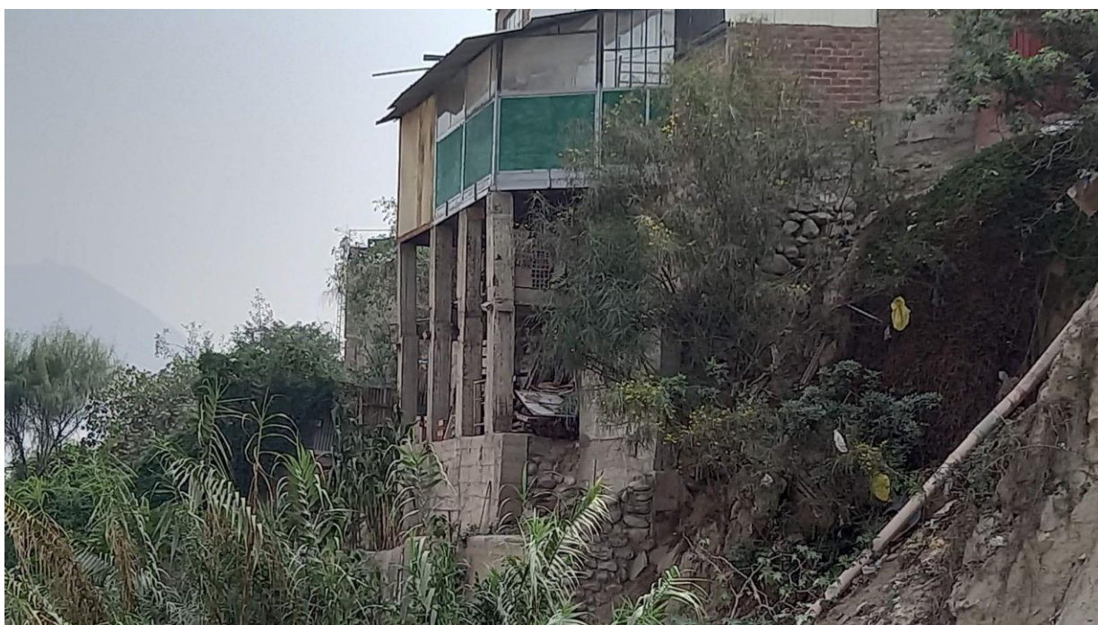
Vista desde el puente de una vivienda con columnas expuestas junto al río.
